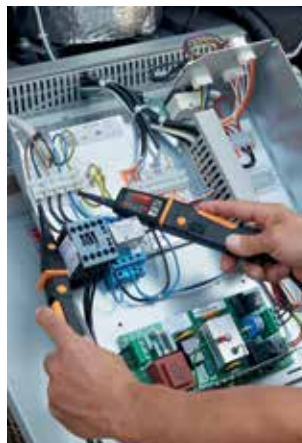
Измерение напряжения на компрессоре.
