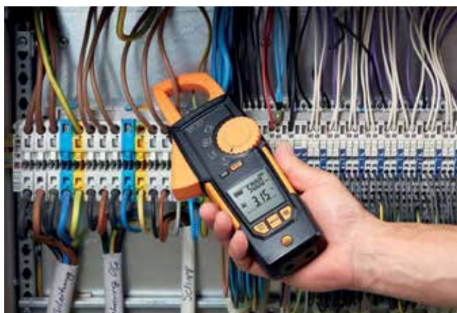
Измерение силы тока в распределительном щитке.
