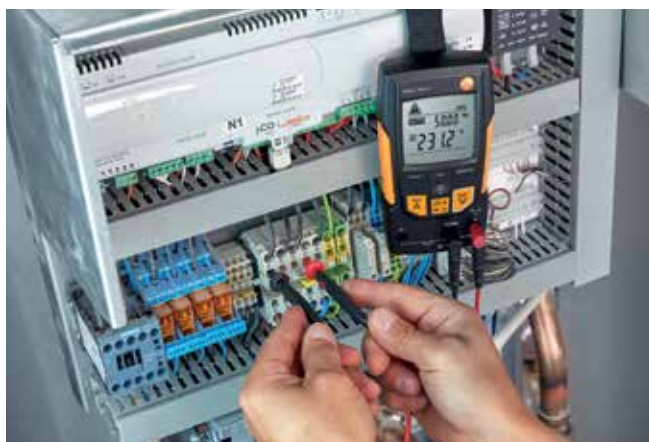
Проверка напряжения в распределительном щитке теплового насоса.
