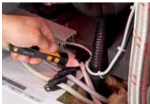
Первый тест подачи напряжения на компрессоре
