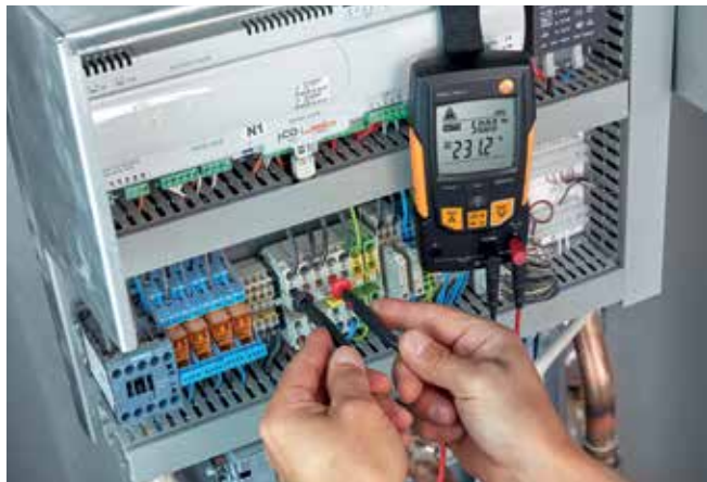
Проверка напряжения в распределительном щитке теплового насоса.
