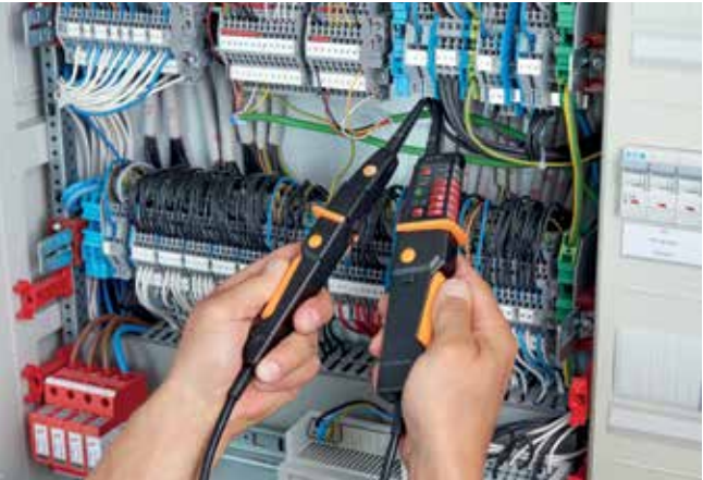
Измерение напряжения в распределительном щитке.
