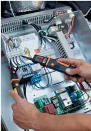
Измерение напряжения на компрессоре.
